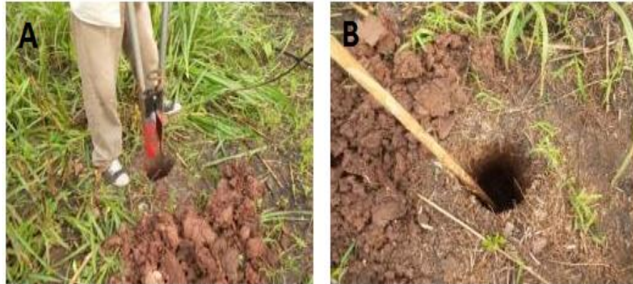
Figura 8: Excavación de hoyos para el prendido de los tutores muertos; A. Inicio de la excavación de hoyos; B. Hoyo terminado.
